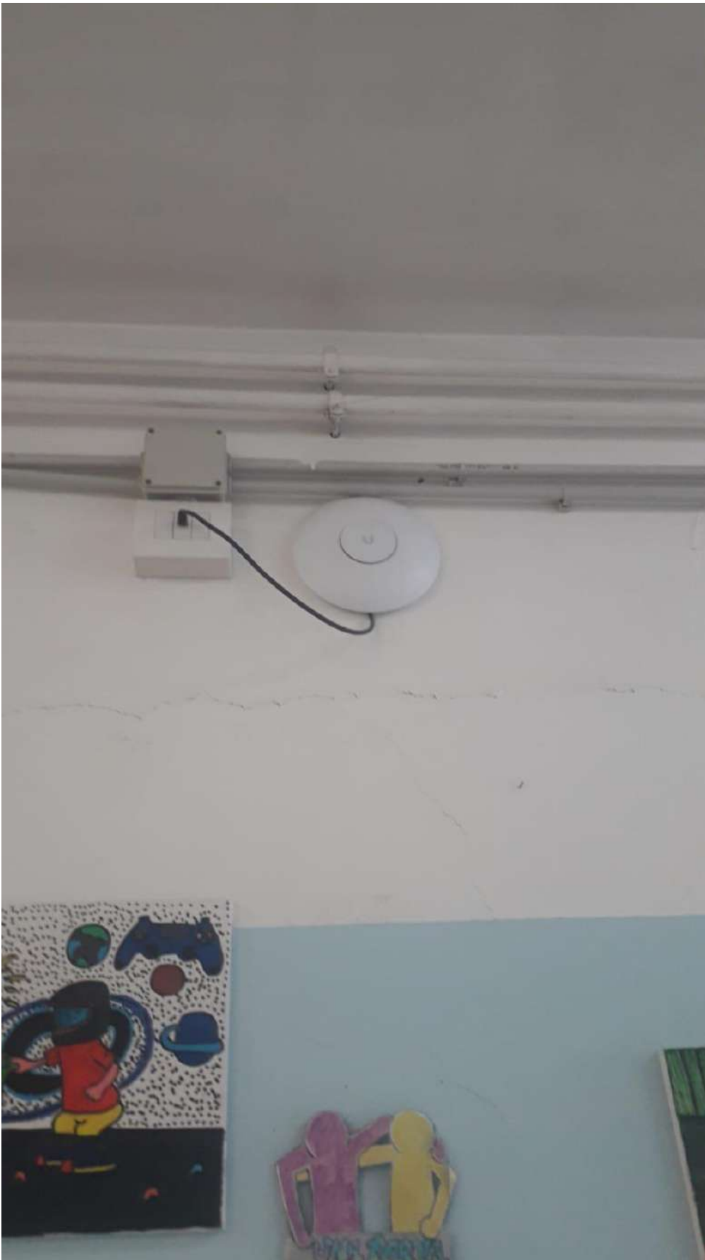
La cavetteria di collegamento utilizzata e i punti rete installati sono tutti di categoria CAT5
